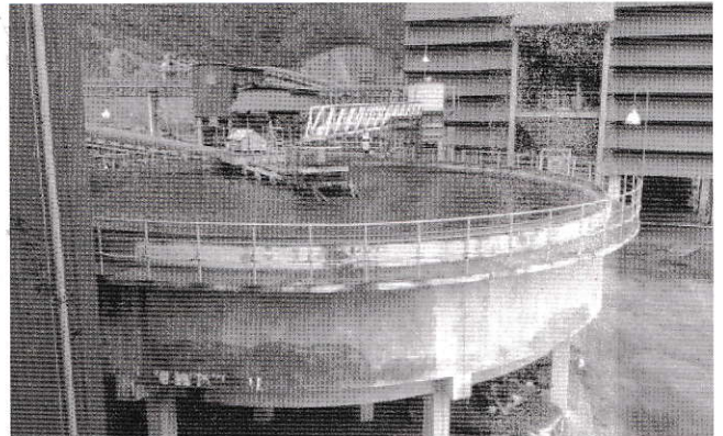
H.3. Hình ảnh máy cô đặc DB-18 đã lắp đặt tại Nhà máy tuyển than Vàng Danh II
