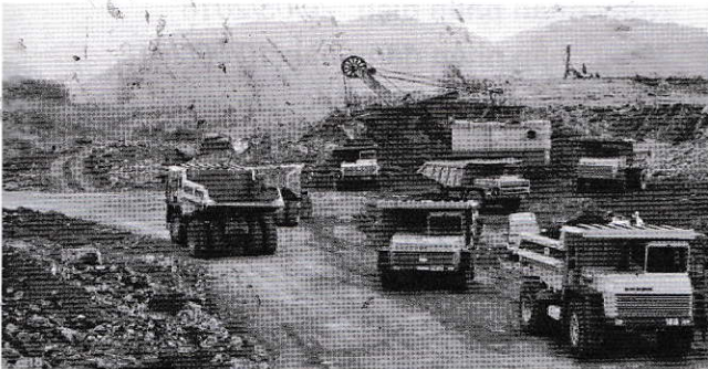
Ảnh 4. Ô tô BELAZ và máy xúc điện EKG E=2,8-3,2m 3 trên công trường [7]
