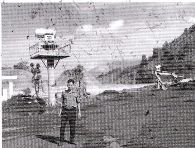
H.4. Hình ảnh thiết bị phun sương 3WD2000-60 được lắp đặt ở kho than mỏ Khe Chàm III
