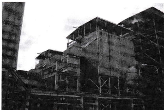
H.3. Ảnh hệ thống lọc bụi ESP
