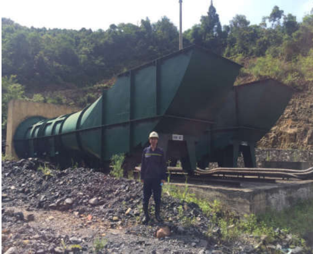
H.3. Hình ảnh của quạt FBCDZ-No20 mức +320, khu Đồng Vông, Tân Dân, Công ty than Uông Bí-TKV
