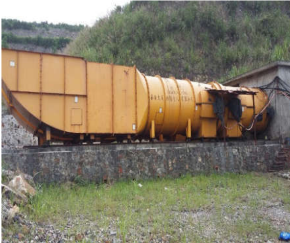
H.5. Trạm quạt FBCDZ-No 24 /2x280, mỏ than Hà Lầm
