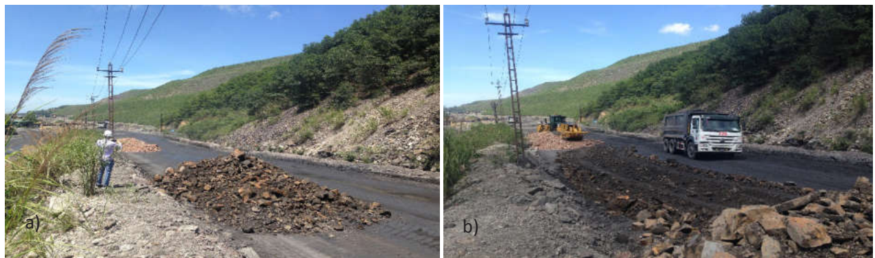
H.5. Hiện trạng công tác duy tu, sửa chữa mặt đường bị hư hỏng a- công tác đổ đồng; b- công tác san gạt tạo phẳng
