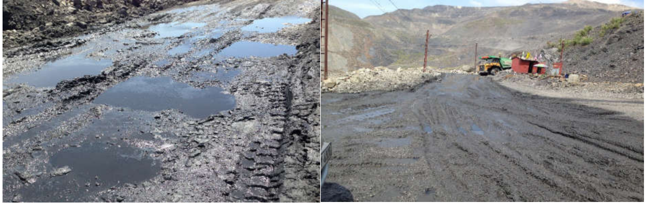
H.4. Tình trạng hư hỏng và xuống cấp mặt đường sau những trận mưa
