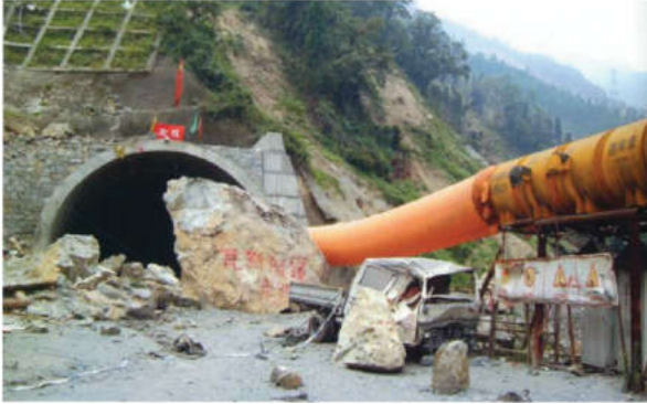
a- Phá hủy cửa hầm phía đông của đường hầm
