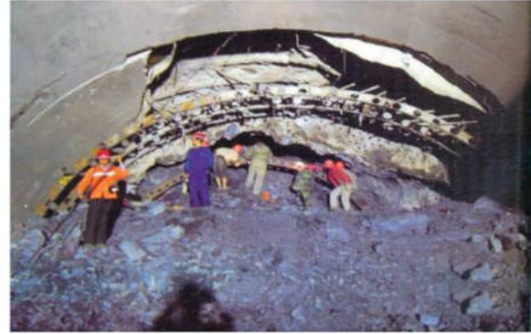
b- Phá hủy vỏ chống đường hầm
