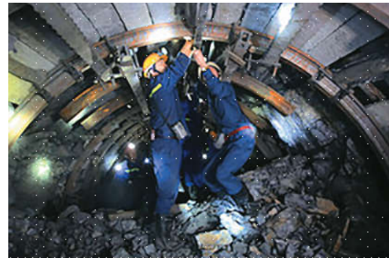
H.1. Kết cấu chống lò tại mỏ than hầm lò thuộc Công ty CP than Vàng Danh
