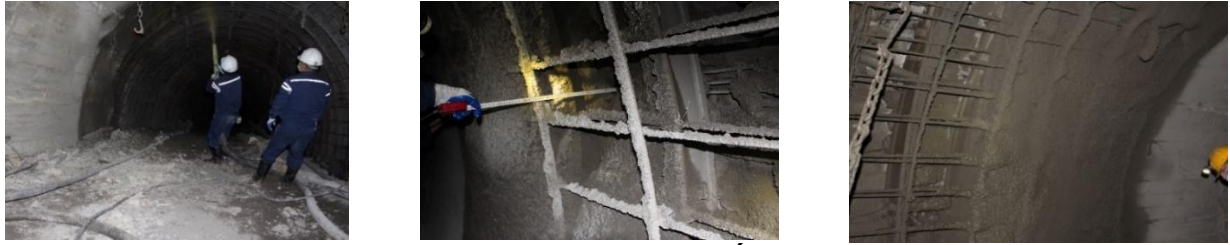
Hình 5. Thử nghiệm phun bê tông ướt thi công vỏ chống bê tông lưu vi tại Công ty than Hà Lâm
