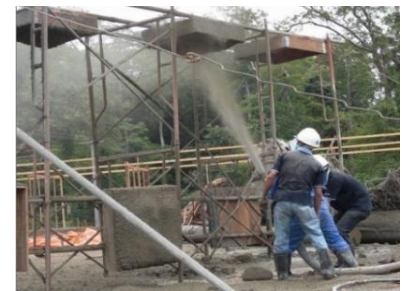
c. Thử nghiệm phun bê tông với chiều dày lớn trong 1 lần phun tại nhà máy thủy điện Namphak, Lào
