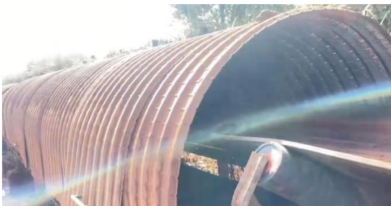
Hình 3. Con lăn nhựa UHMW- PE lắp trên băng tải vận chuyển quặng bauxit của Công ty TNHH Một thành viên Nhôm Lâm Đồng – TKV
